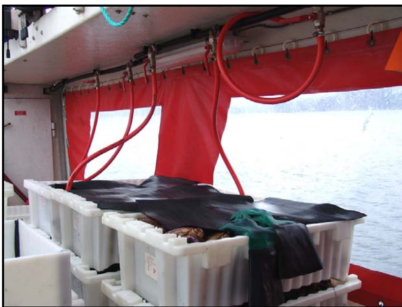
Figur 3 Et bilde av endringene på vanningsystemet på shelterdekk med nytt rør, kraner og slanger.
